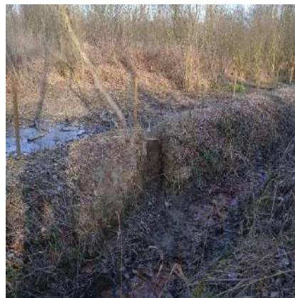
Estat del rec de la palanca
