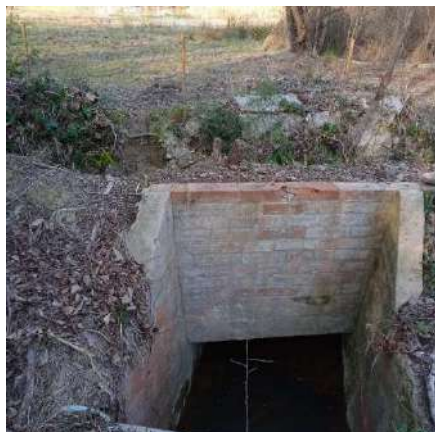
Punt d'instal·lació de comporta CC
