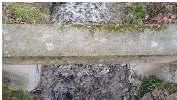
Punt de reparació de comporta CA
